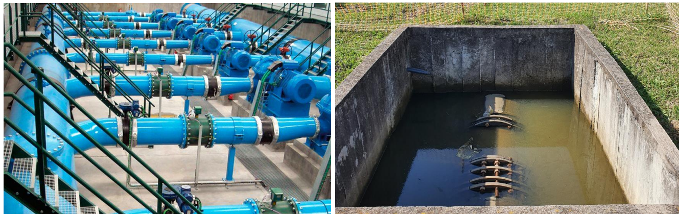
Figura 2 – Medidores de Vazão
