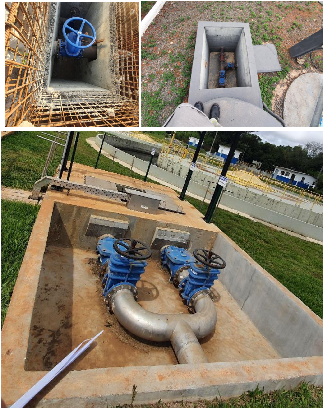
Figura 1 – Montagens em caixas enterradas sem elementos para desmontagem
