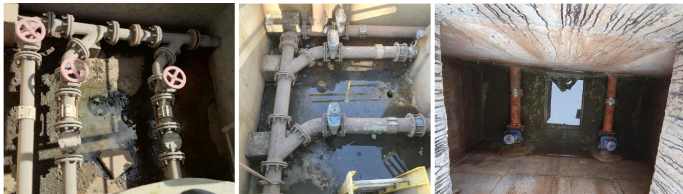
Figura 7 – Acúmulo de água nas caixas enterradas
