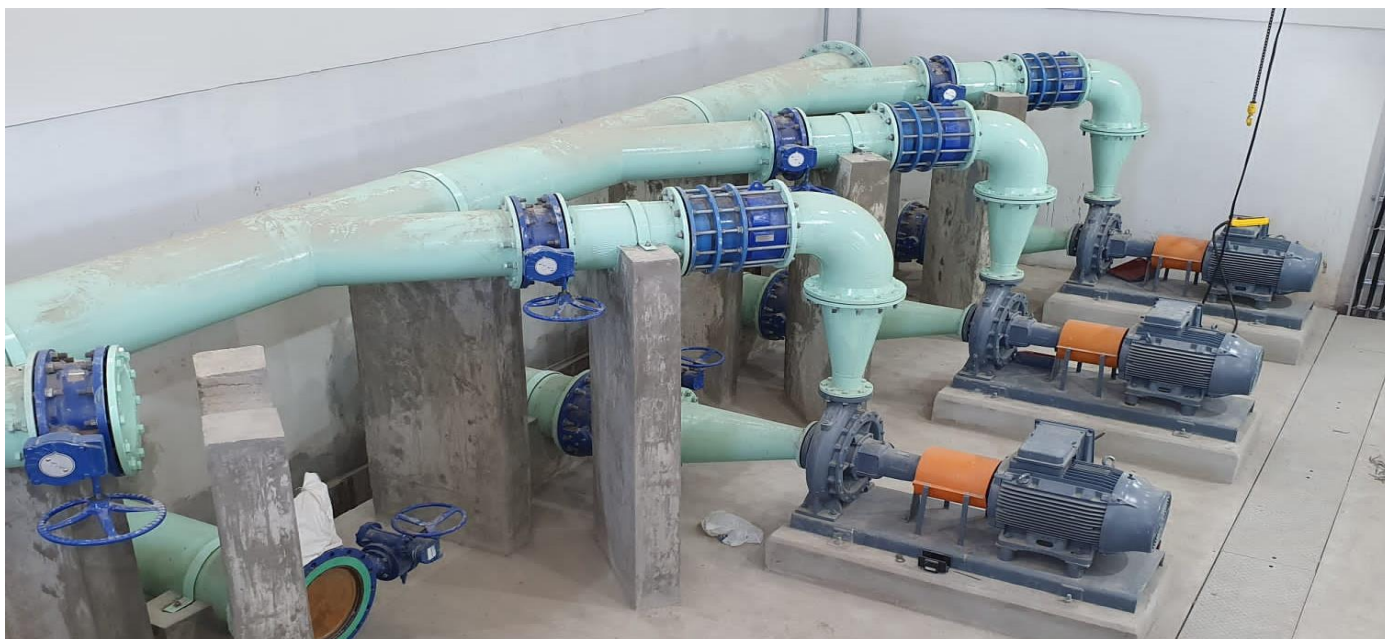
Figura 3 – Barrilete de distribuição de água em reservatório.
